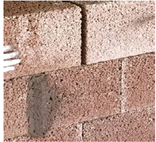
Stoßfugen rechts knirsch Stoßfugen links vermörtelt
